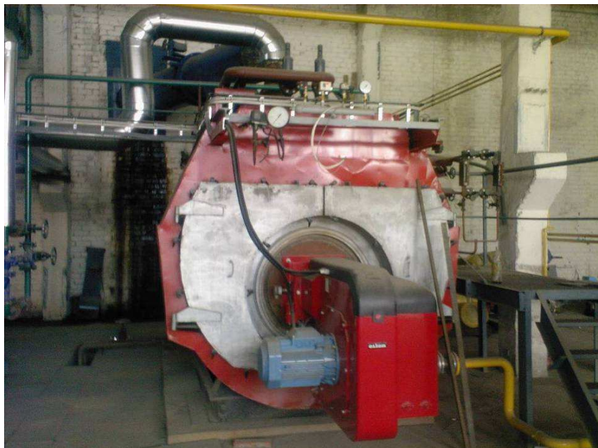
Fig. A.4-6. Gas boiler CKD Ducla
