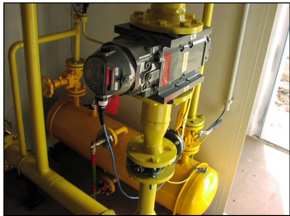
5-2. ábra: Gázmérő, -szagosító berendezés
