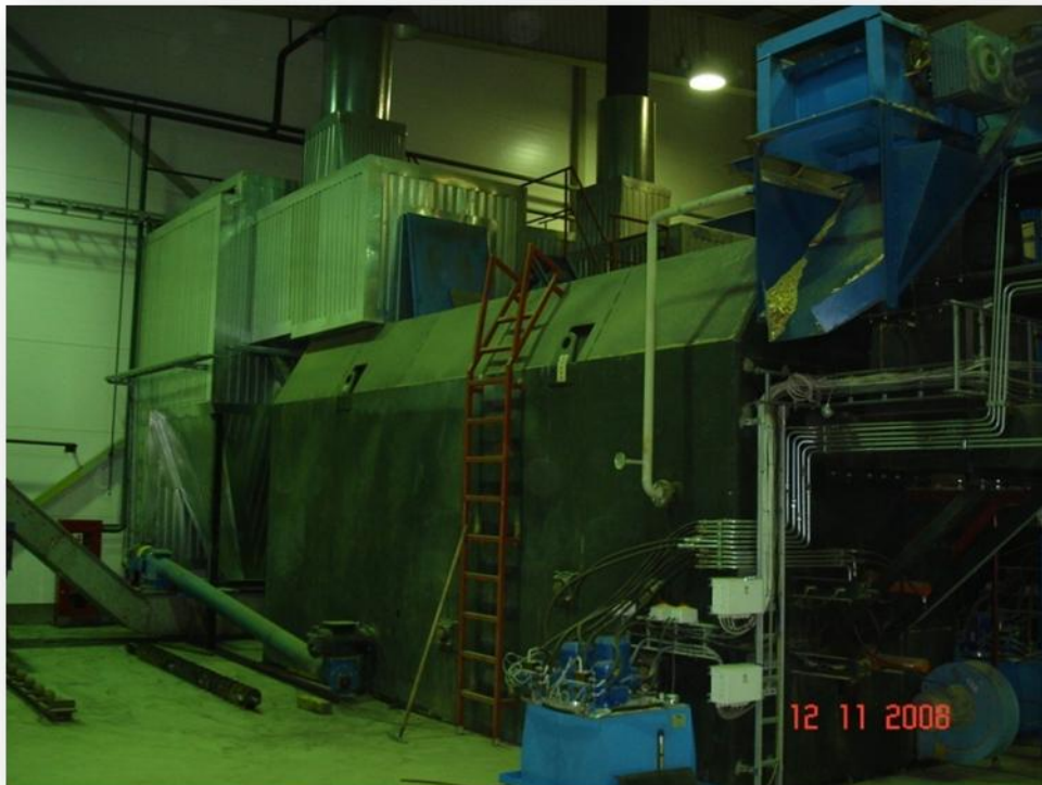
Fig. A.4-5. Heat generator
