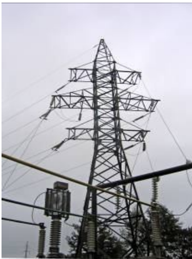
SS-110/10 «Tsentralna». Access PL-110 kV to SS «Tsentralna».
