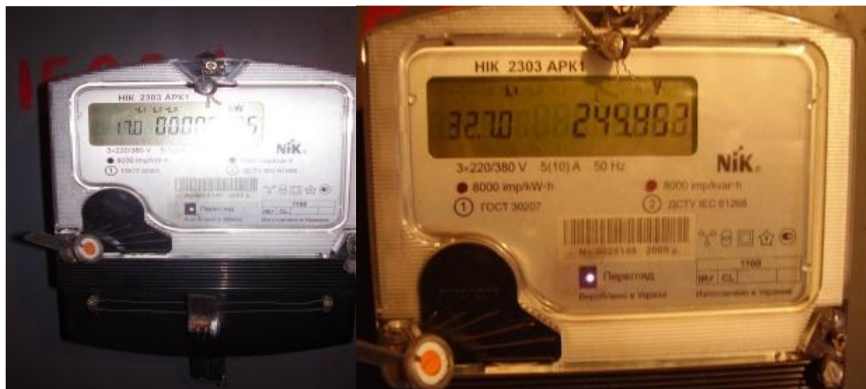
Figure 8 Electricity meter «NIK 2303ARK1»
